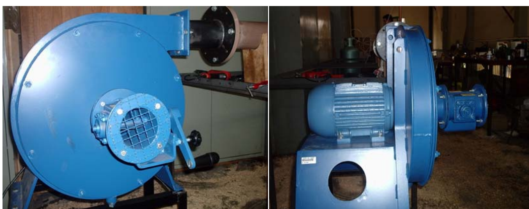
Fig. 5.5 - Fotos do ventilador instalado
